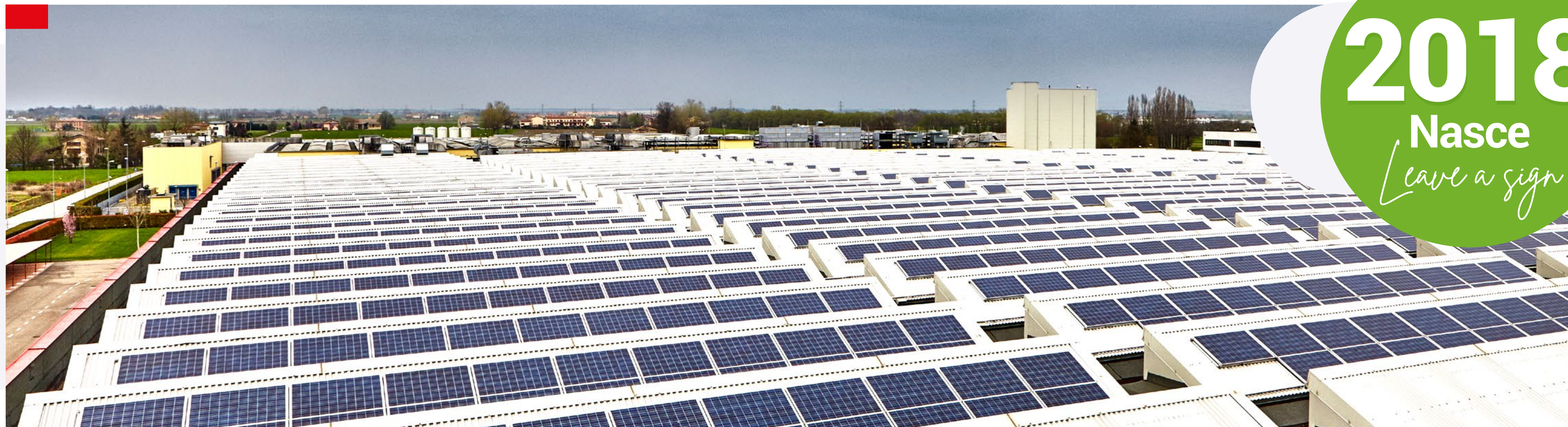
Grande tetto fotovoltaico
